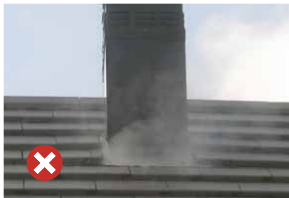
Onbedoelde luchtlekken, waargenomen tijdens blowerdoortest met rookproef.
