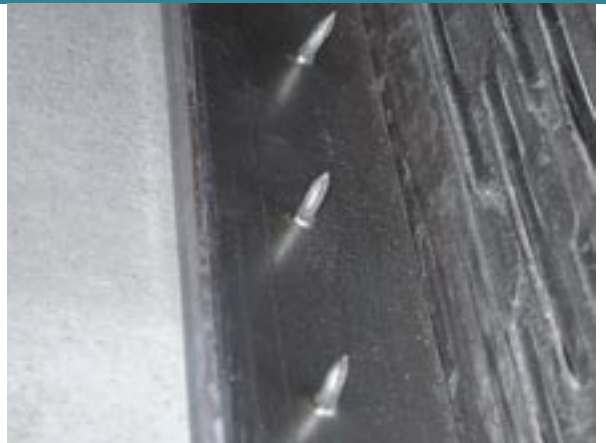
48. Getordeerde nagels in een staalprofiel.
